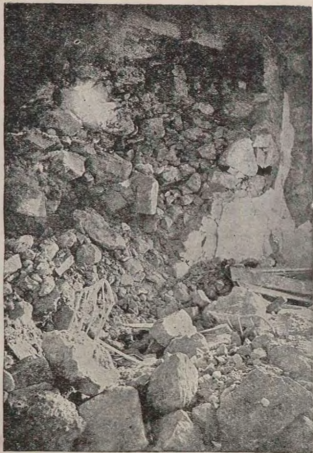
Верхняя Ореанда. Санатория Зап. Воен. Округа. Обвал стены вовнутрь помещения. Кровать сестры милосердия, заваленная камнями
