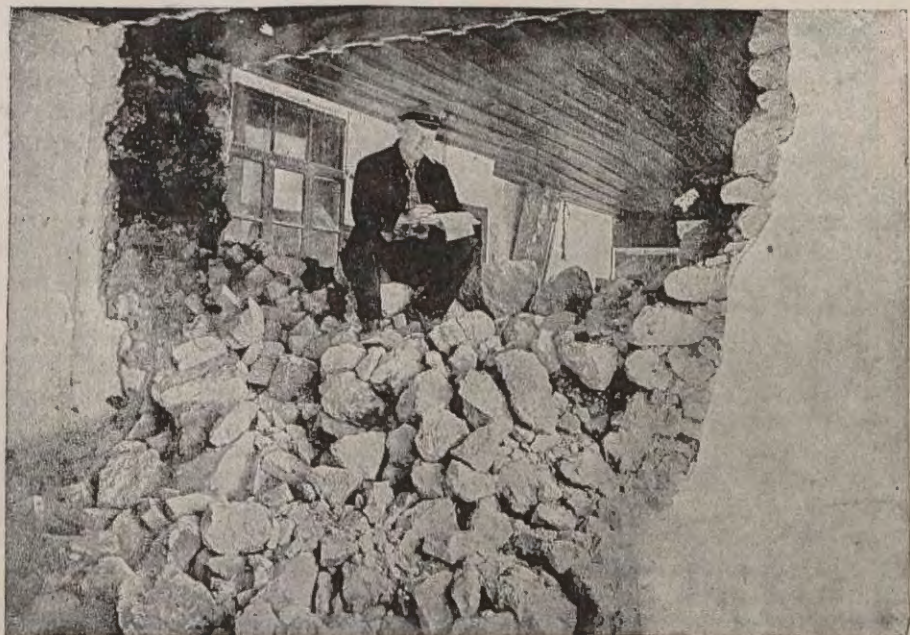
Дер. Кекенеиз. Здание сельсовета у шоссе. Выпадение зап. толстой внутренней стены из бутовой кладки на глине
